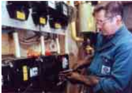
Fig. 111. Le compteur d'énergie comptabilise les kWh entrant dans notre habitation. Chaque année, un employé d'Electrabel vient contrôler l'indice pour établir la facture finale.
